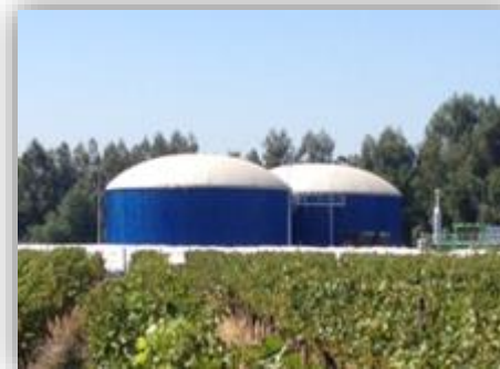
Digestión anaeróbica, Viña San Pedro- BioG
