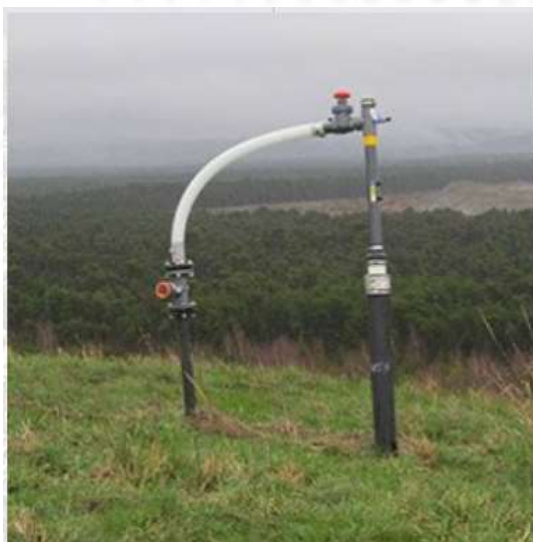
CAPTURA DE GAS DE RELLENOS SANITARIOS
